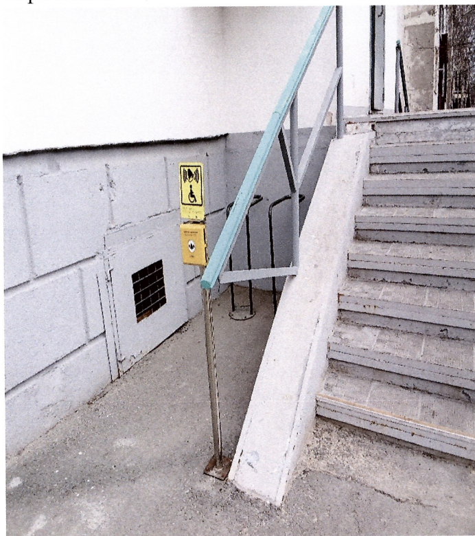
ФОТО №5 Лестница, кнопка вызова персонала
